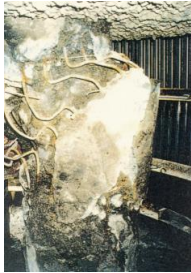
杭基礎の損傷
