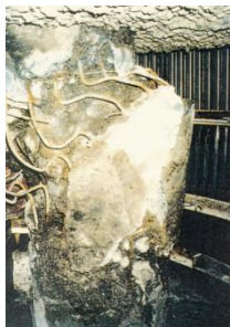
杭頭部の損傷
